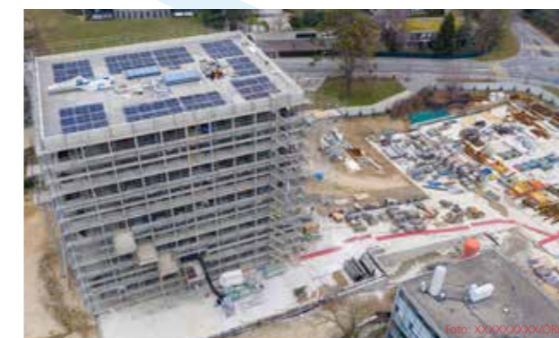
Auf dem Dach des Montreal-Gebäudes werden Solarkollektoren installiert, während rechts die Baustelle für das Kyoto-Gebäude vorbereitet wird.
